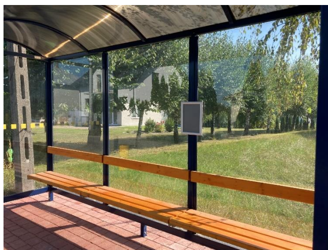
Zdjęcie 30. Przystanek pozbawiony rozkładu na terenie OF Myślenic
